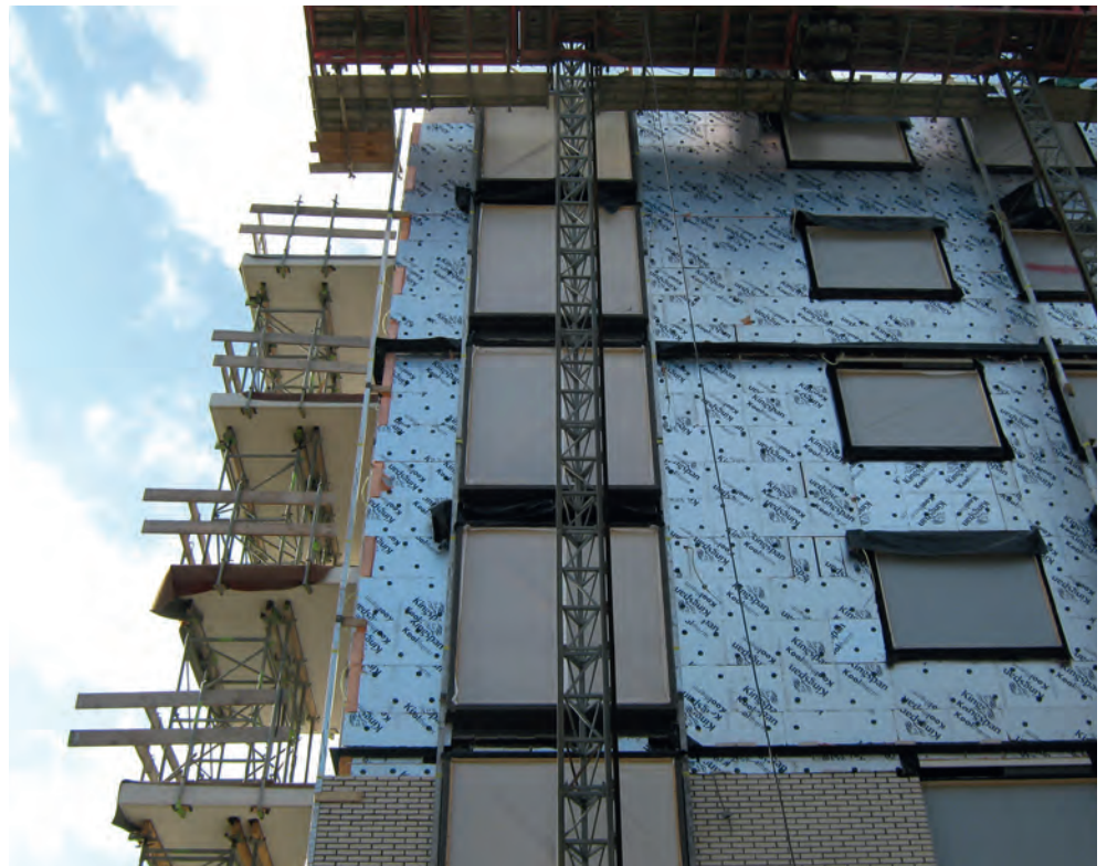
Vleuterweide, Utrecht (2012). Realisatie van een hoogwaardige thermische schil binnen de gebruikelijke geveldikte door toepassing van isolatiemateriaal met gunstige thermische kwaliteit.
